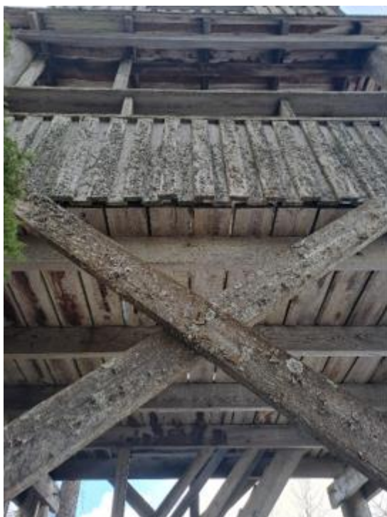
Kuva 13. Jäkälä peittää rakenteita.
