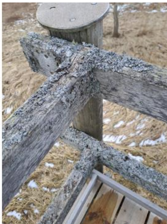
Kuva 33. Jäkälää rakenteiden pinnassa.
