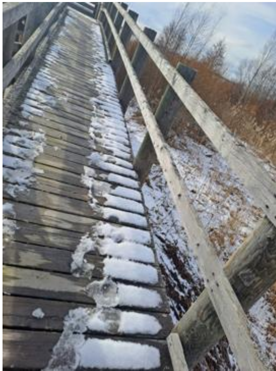
Kuva 66. Rampin puuttuva alakaide.
