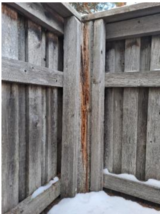
Kuva 15. Kaiteen sivutolpan lahovaurio.
