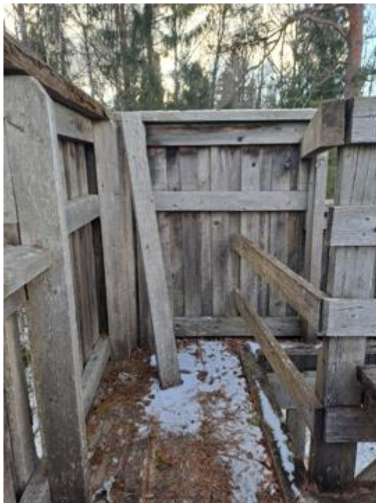
Kuva 19. Ylätasanteen irronnut kaide.
