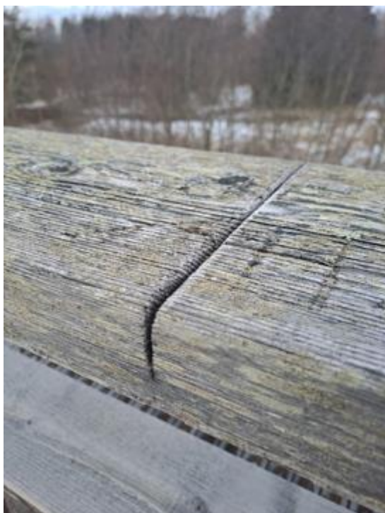
Kuva 32. Ilkivaltaa kohdannut kaide.
