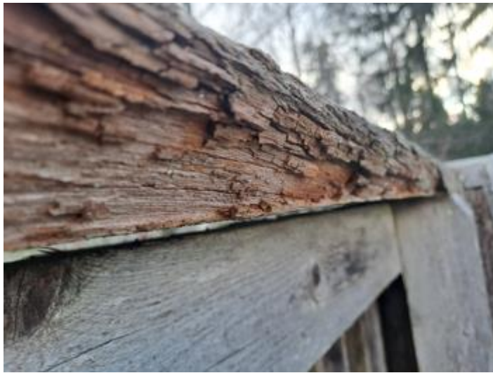
Kuva 17. Kaiteen kansipuun lahovaurio.
