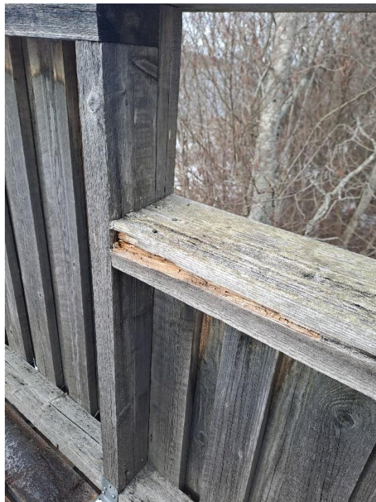
Kuva 40. Ylätasanteen kaiteen lahovaurio.
